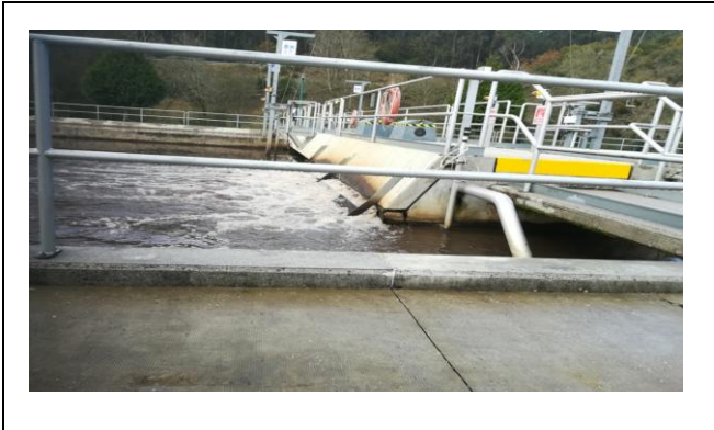
En la depuradora de Aríns.
